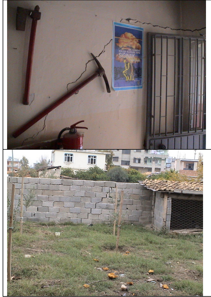
Şekil 2A.8.Maşuklu İlköğretim Okulu ve bahçe duvarındaki yapısal hasarlardan örnekler
